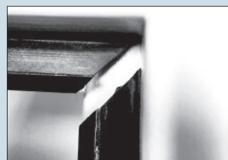
Dichtungsmontage Rahmenstock: falsch ✗
