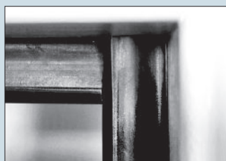
Dichtungsmontage Rahmenstock: falsch ✗
